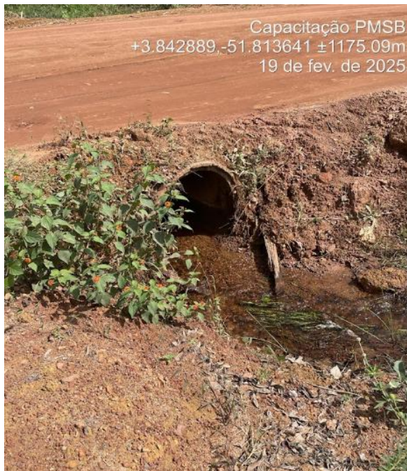
c) Galeria de travessia de rua sem declividade e com ausência de borda para conter erosão.
