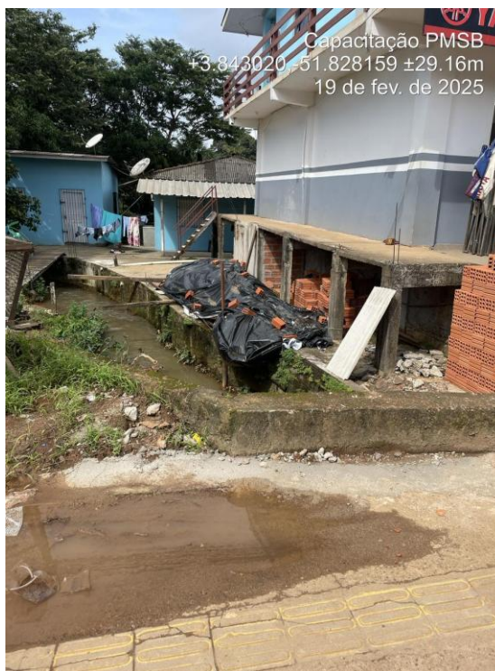
Fotografia 5.5: Esgoto direcionado ao sistema de drenagem em Oiapoque-AP
