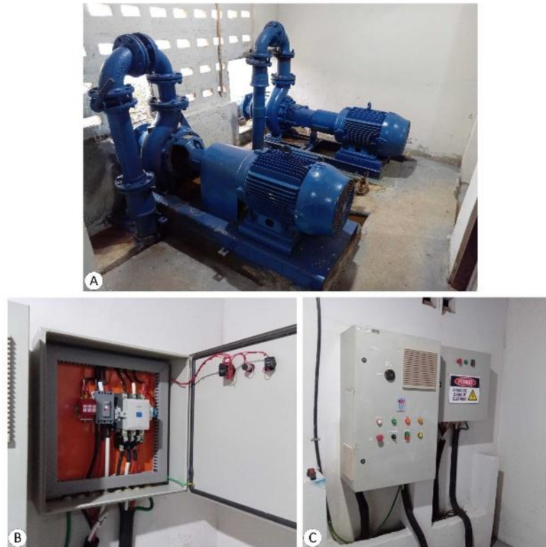
A – Conjuntos motobombas (principal e reserva); B – Painel de acionamento do conjunto motobomba principal; C – Painel de acionamento do conjunto motobomba reserva
