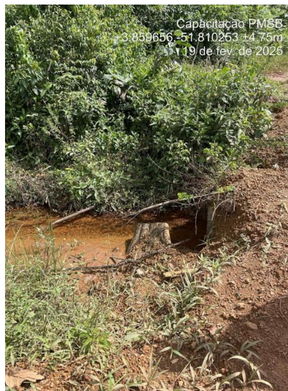
f) Registro da galeria de saída diretamente no terreno sem revestimento adequado.
