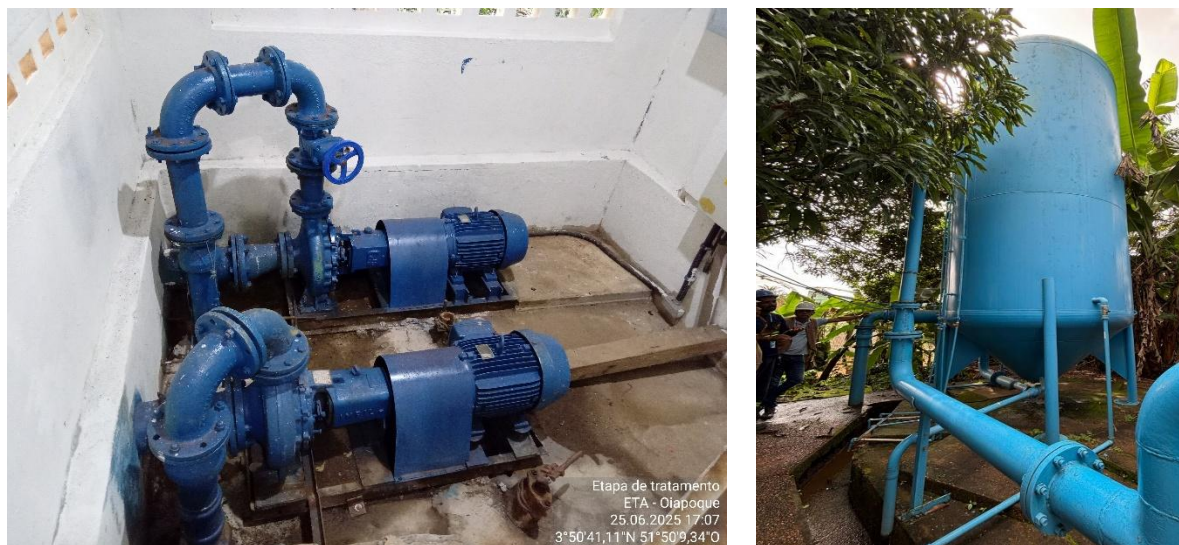
(A) Motobombas de recalque de água bruto do porão
