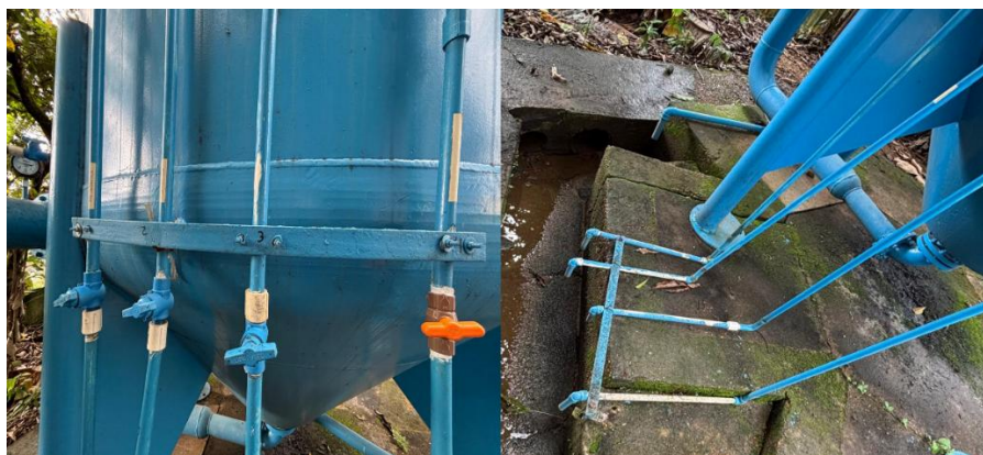
Fotografia 4.6: Torneiras de amostragem instaladas em diferentes níveis do floculador-decantador
