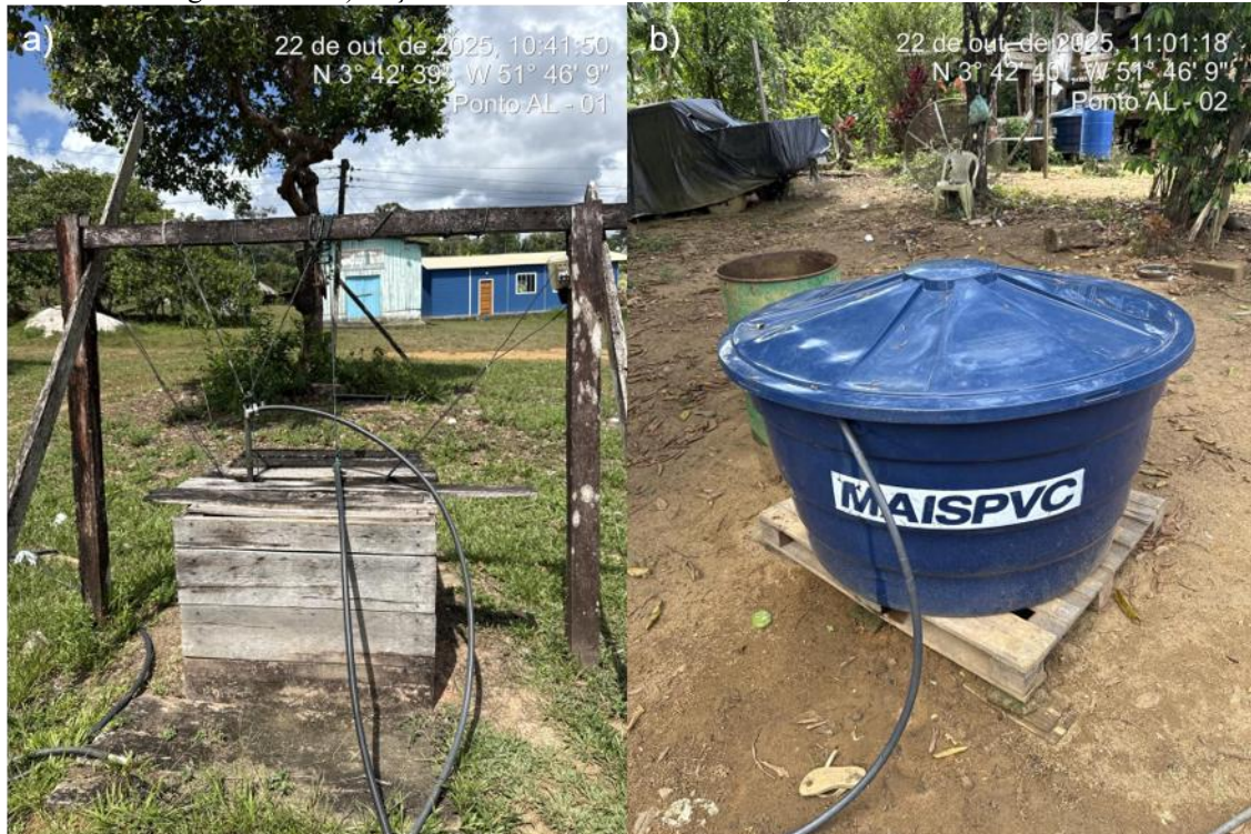
Fotografia 4.15: a) Poço Amazonas na Aldeia Kuahi. b) Reservatório Aldeia Kuahi
