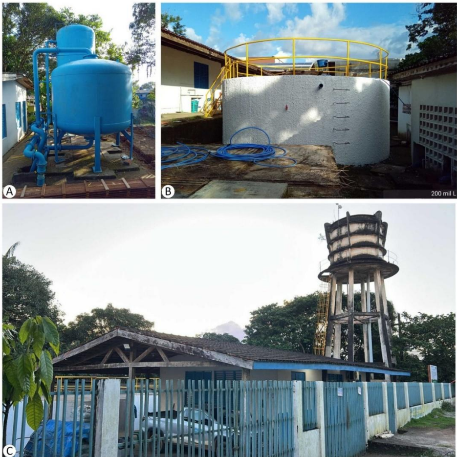
A – Módulo floculador-decantador e filtro; B – Reservatório apoiado; C – Vista geral da ETA e Reservatório elevado
