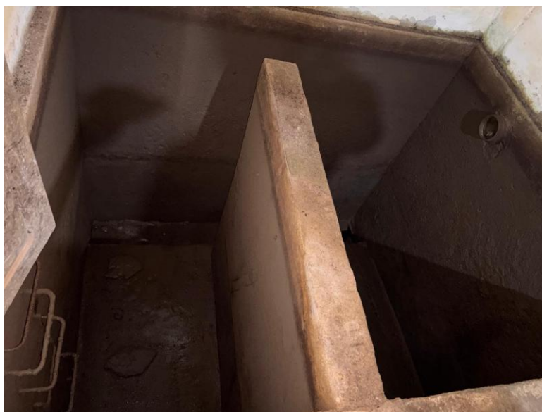
Fotografia 4.3: Porão de reservação de água bruta
