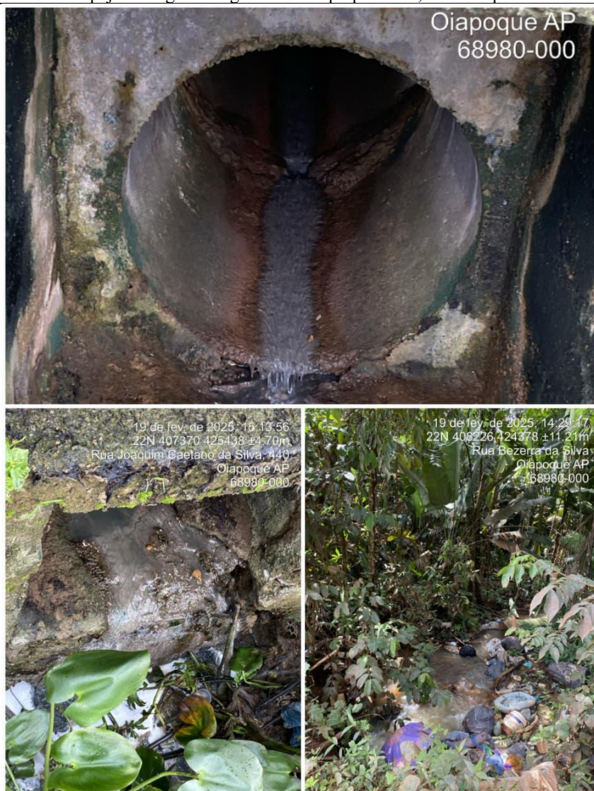
Fotografia 5.4: Despejo de esgoto irregular em Oiapoque – AP, Rua Joaquim Caetano da Silva.
