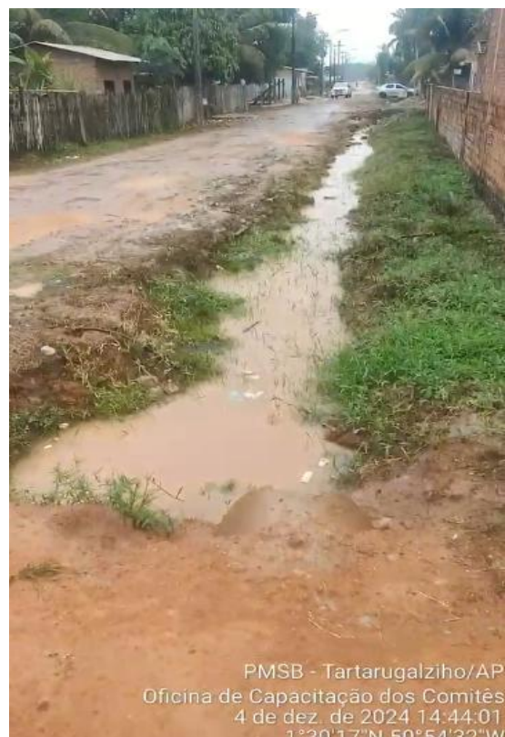
b) Galeria pluvial conectada a canaleta sem revestimento (cava de drenagem)
