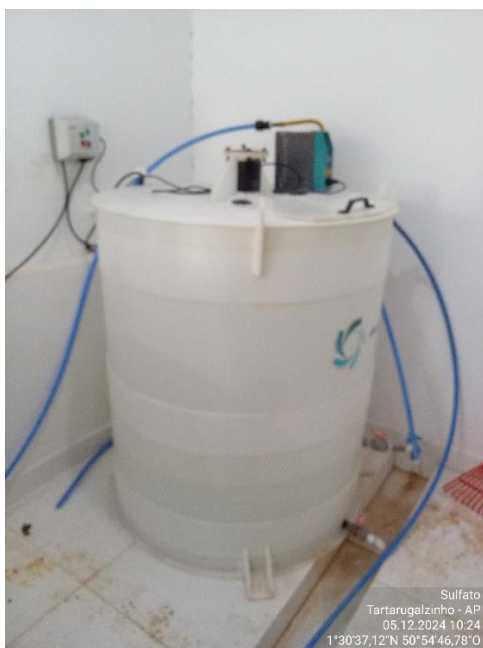
a) Tanque de polietileno branco ( Skid ) de mistura
