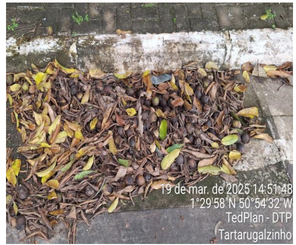
b) Registro de Boca de Lobo com elevado nível de obstrução por vegetação e outros elementos.
