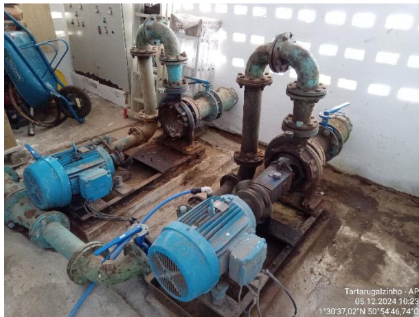
a) Conjunto motobombas de 20 CV cada
