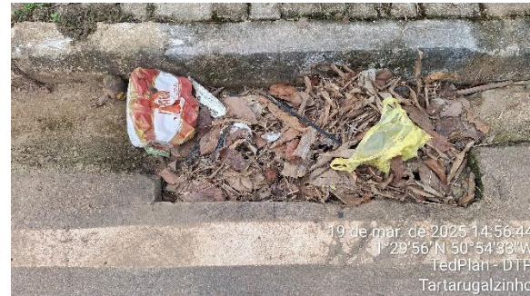
d) Dispositivo de drenagem totalmente obstruído
