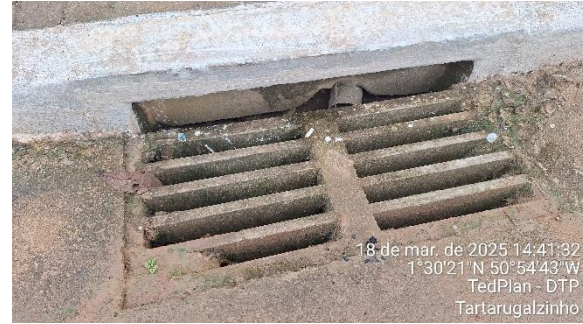
b) Dispositivo de drenagem com ligação clandestina de esgoto
