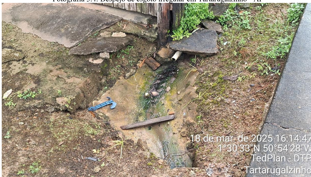
Fotografia 5.4: Despejo de esgoto irregular em Tartarugalzinho - AP
