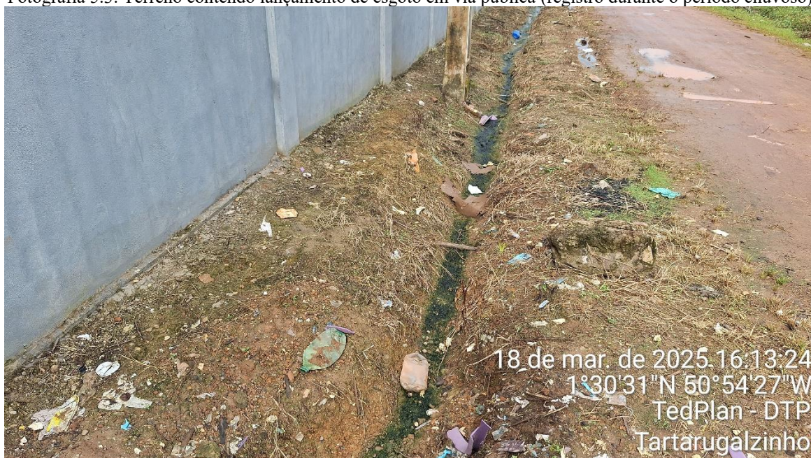
Fotografia 5.3: Terreno contendo lançamento de esgoto em via pública (registro durante o período chuvoso)
