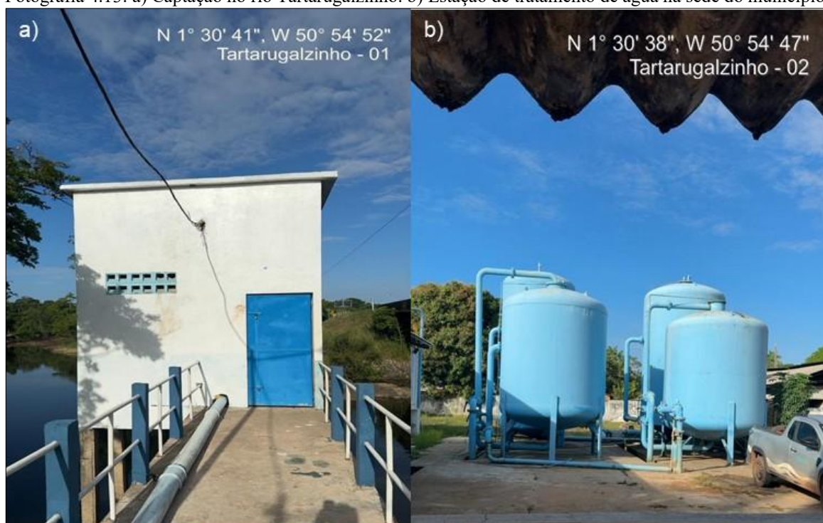
Fotografia 4.13: a) Captação no rio Tartarugalzinho. b) Estação de tratamento de água na sede do município.
