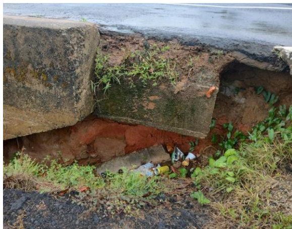
a) Erosão na cabeceira da ponte na porção norte do bairro Centro.
