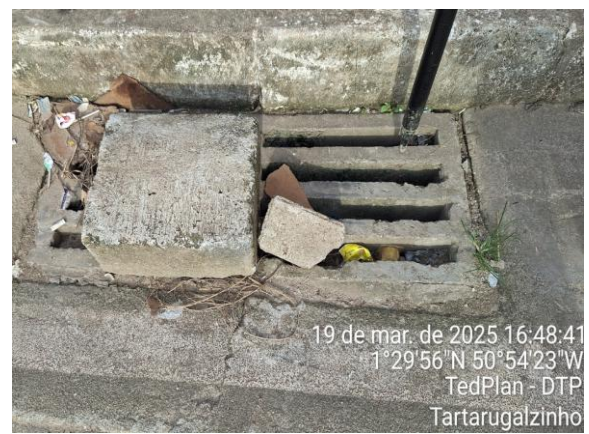
f) Registro de obstrução parcial do tipo entulho no dispositivo de drenagem tipo Boca de Lobo
