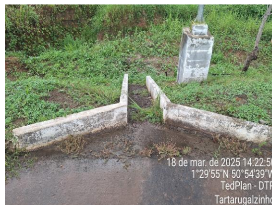
b) Registros de quedas de água nas adjacências da BR-156, com seção insuficiente
