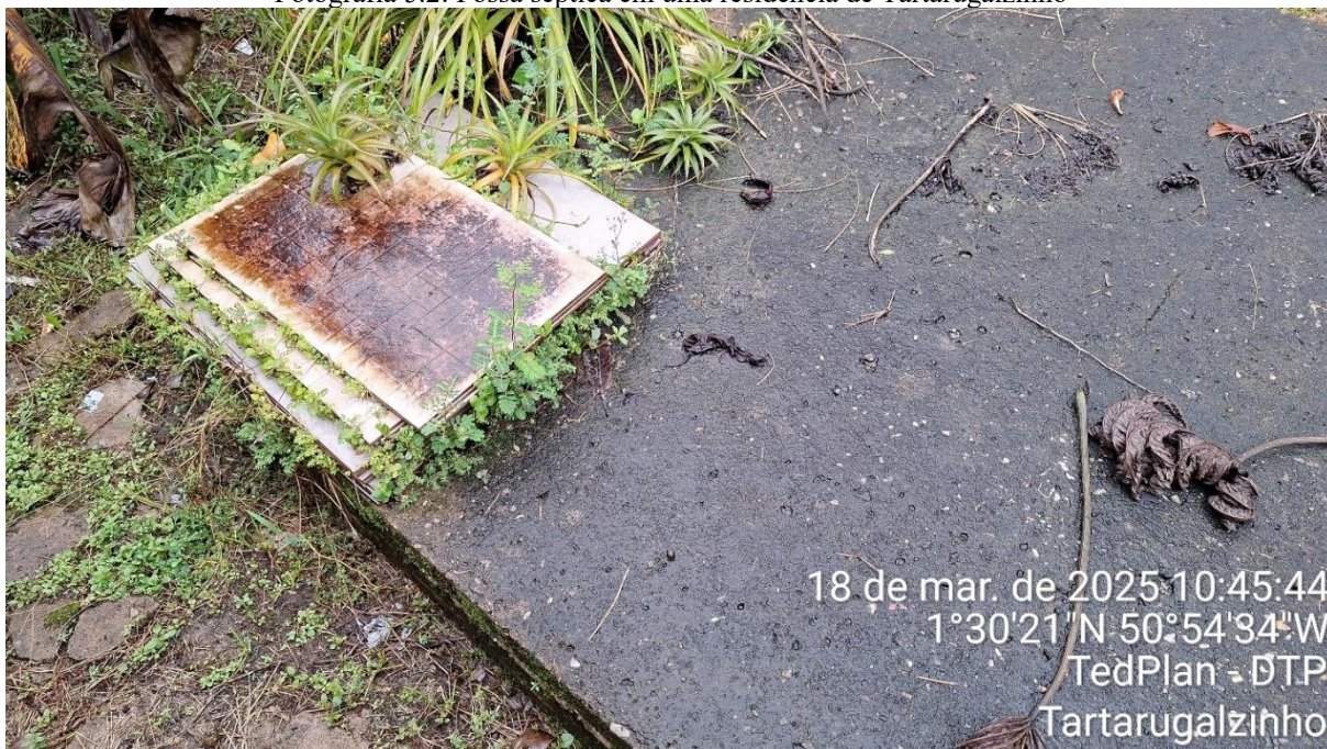
Fotografia 5.2: Fossa séptica em uma residência de Tartarugalzinho
