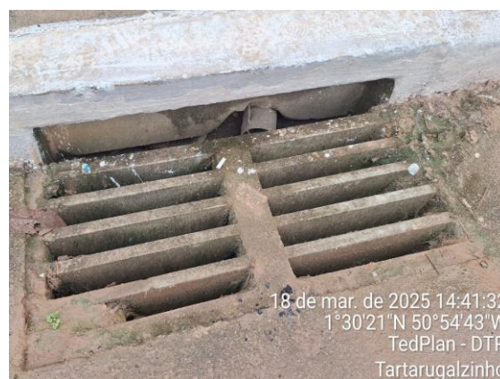
d) Boca de lobo com lançamento de esgoto clandestino (Bairro Centro)
