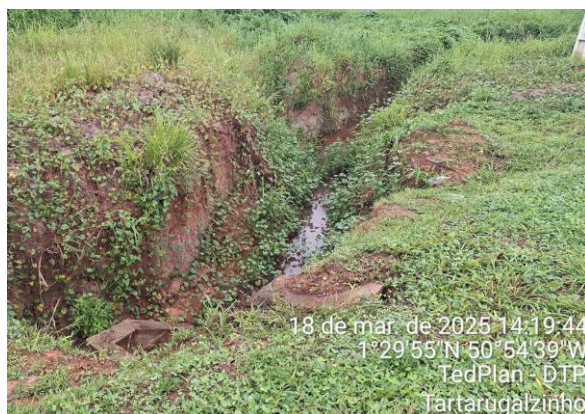
a) Galeria em manilha de concreto com diâmetro Ø 1000mm sobre trecho pavimentado (ponto de saída na BR-156)
