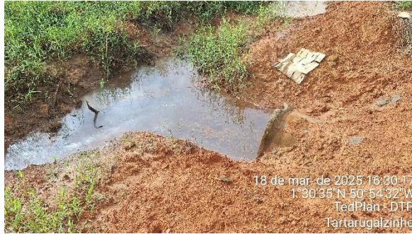
a) Galeria de drenagem com presença de efluentes de esgoto
