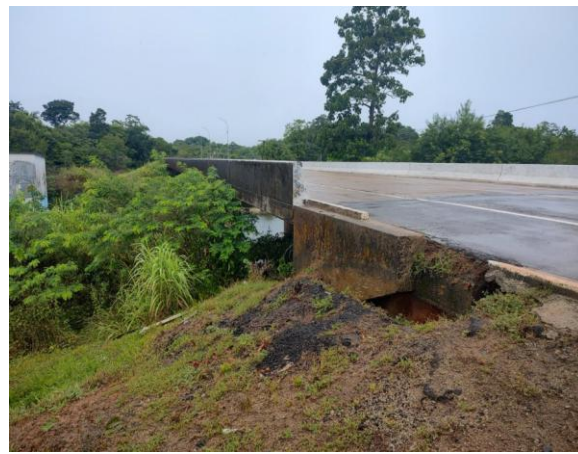
b) Registro em ângulo aberto da erosão por ausência de dispositivos de drenagem a jusante da Ponte.
