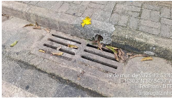
c) Dispositivo de drenagem com ligação clandestina de esgoto
