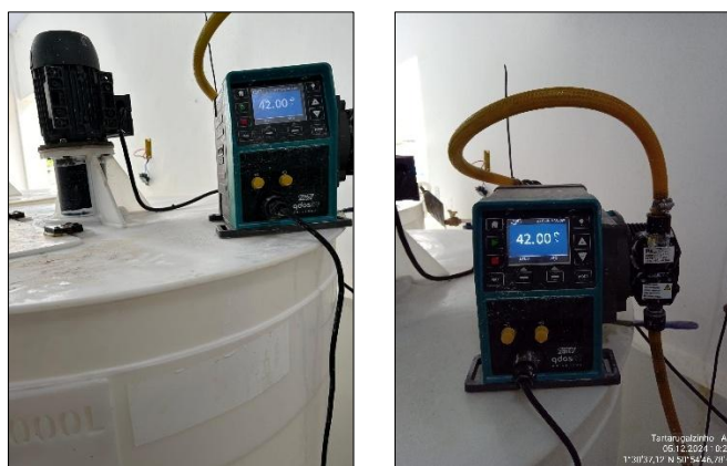
c) Bomba dosadora de cloro marcando 42 L/h
