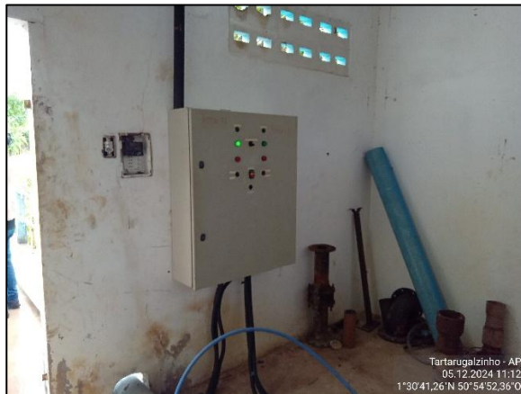
c) Quadro elétrico de acionamento
