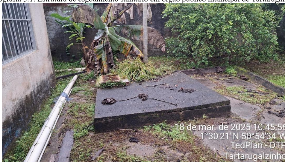
Fotografia 5.1: Estrutura de esgotamento sanitário em órgão público municipal de Tartarugalzinho
