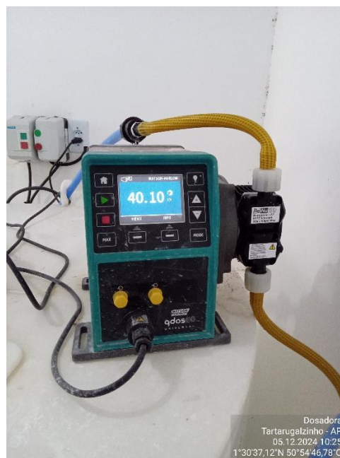
b) Bomba dosadora da solução de sulfato de alumínio
