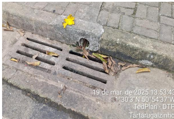
c) Registro de dispositivo de drenagem do tipo Boca de Lobo com lançamento de esgoto clandestino.
