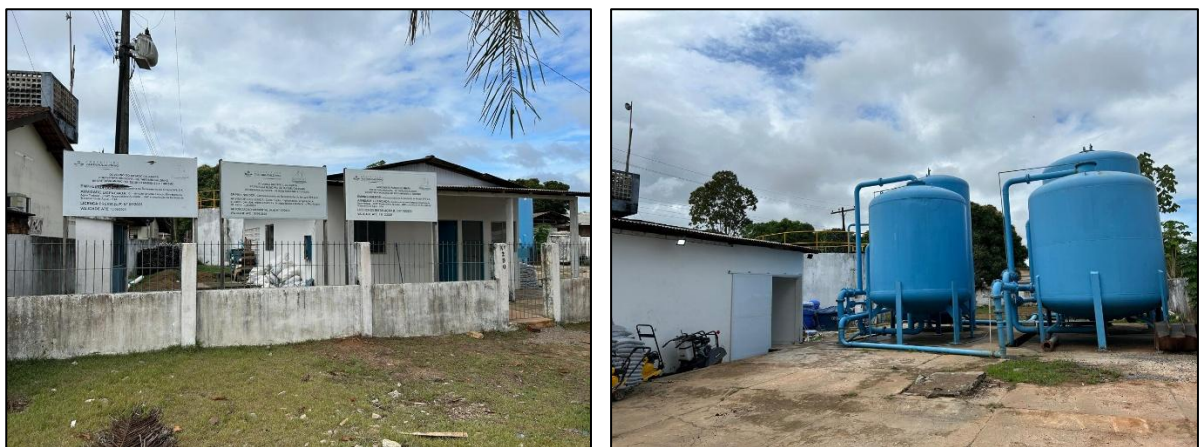
Fotografia 4.3: Estação de tratamento de água (ETA) compacta – vista geral da ETA Compacta
