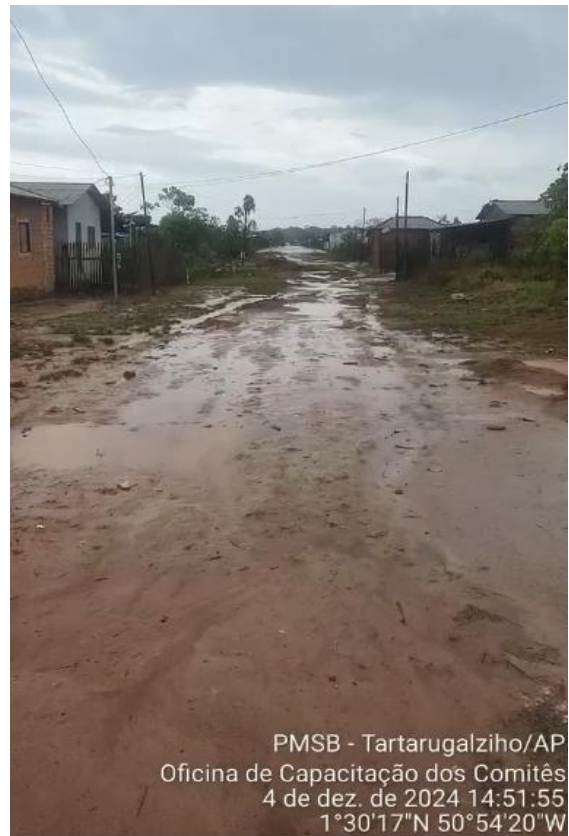
d) Registro da Ausência de sistemas de infraestrutura urbana e conseqüentemente erosão da via (Bairro Nova Morada)
