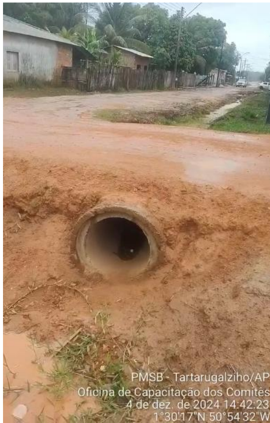
c) Galeria de travessia de rua com declividade invertida ou insuficiente (Bairro Nova Morada)
