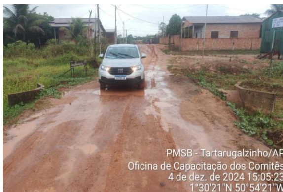
e) Galeria de travessia de rua sem revestimento e proteção e susceptibilidade de erosão da plataforma de pavimento. (Bairro Nova Morada)
