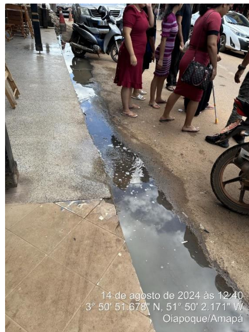
n) Esgoto a "céu aberto"
