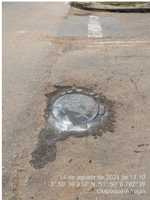
k) Situação rede de esgoto
