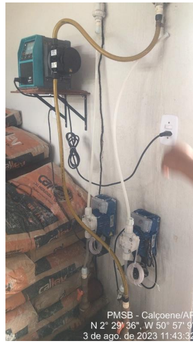
j) Sistema de cloração – bombas dosadoras
