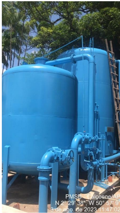
i) Floculador e decantador - ETA
